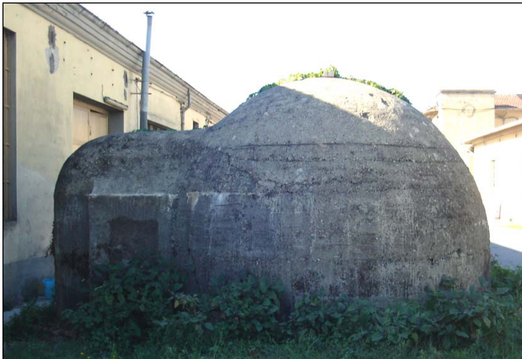
Manufatto a copertura di uno dei pozzi dimessi in corrispondenza del futuro LOTTO A
